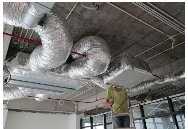
Thông gió cho nhà máy
